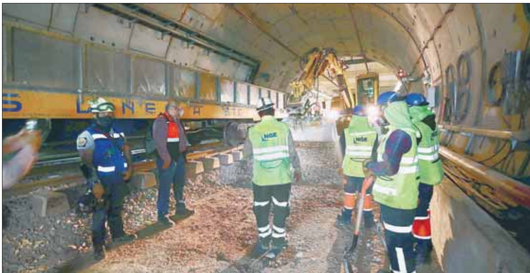
▲ Ayer comenzó la primera etapa de los trabajos de sustitución en siete curvas que se ubican en el tramo subterráneo que va de las estaciones Mixcoac a Atlalilco, de la línea 12 del Metro. El objetivo es renivelar el sistema de vías. Foto Luis Castillo
